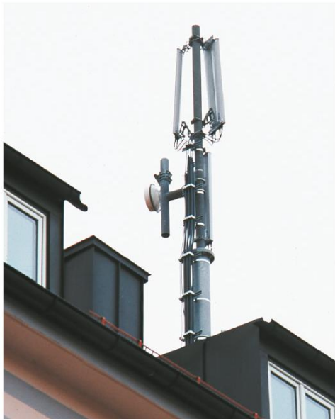
Basisstation auf Wohnhaus
