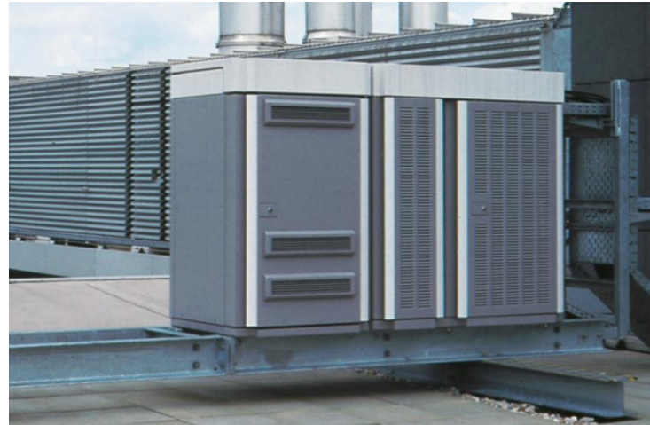
Beispiel: Systemtechnikschrank (im Außenbereich aufgestellt)
