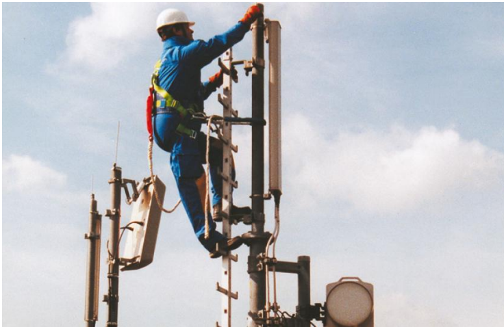
Antennenträger (Dachstandort) mit Sektor- und Richtfunkantennen
