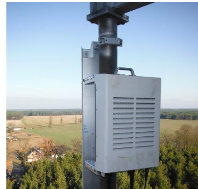
Beispiel: Systemtechnik (im Außenbereich angebracht)
